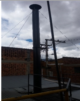
FOTOGRAFÍA 7: PLATAFORMA DUCTO CALDERA
