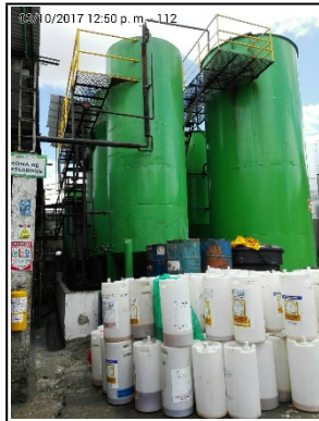
FOTOGRAFÍA 3: TANQUE DE SEDIMENTACIÓN
