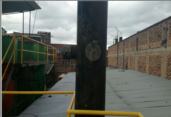
FOTOGRAFÍA 8: PUERTOS Y PATAFORMA DE LA CALDERA
