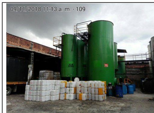
Fotografía 4: Tanques reactores y de almacenamiento
