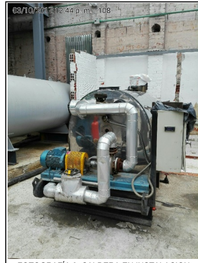
FOTOGRAFÍA 8: CALDERA EN INSTALACION
