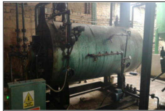
Fotografía 2: Caldera 30 BHP a gas natural*
