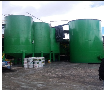
FOTOGRAFÍA 5: TANQUES DE ALMACENAMIENTO
